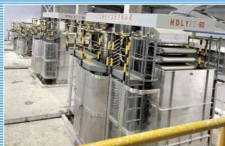
紫金矿业塞尔维亚铜业有限公司 （湿法铜冶炼） Zijin Mining Co.,Ltd Serbia (Cu Hydrometallurgy)
