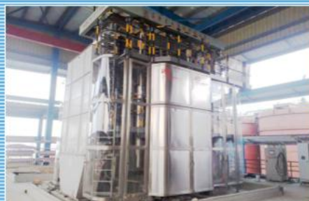
印尼青山美迪卡公司 （湿法镍钴冶炼） PT. Merdeka Tsingshan Indonesia (Ni-Co Hydrometallurgy)
