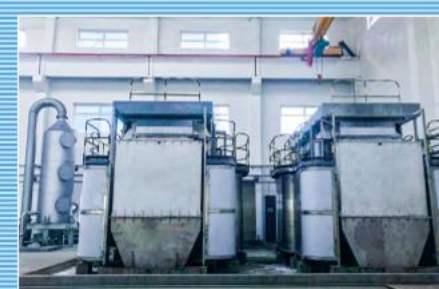
河北钢铁股份有限公司承德分公司（钒冶炼） Hebei Iron & Steel Co.,Ltd Chengde Branch (Vanadium Smelting)
