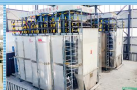
内蒙古泰兴泰丰化工有限公司（染料） Inner Mongolia Taixing Taifeng Chemical Co.,Ltd (Dyes)
